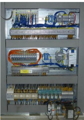
Řídicí systém v novém rozvaděči MaR
